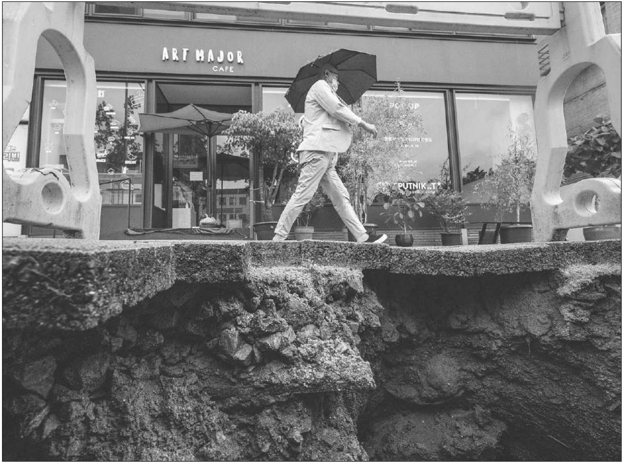
หลังน้ำท่วม ● สภาพความเสียหายของทางเท้าในกรุงไซล เมื่อวันที่ 9 สิงหาคม หลังฝนตกหนักและน้ำท่วมใหญ่เมื่อคืนที่ผ่านมาในกรุงไซลและปริมาณล ทำให้มีผู้เสียชีวิตอย่างน้อย 8 คน
